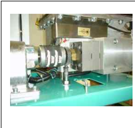
Pumpentrieb mit Drehzahlmessung
